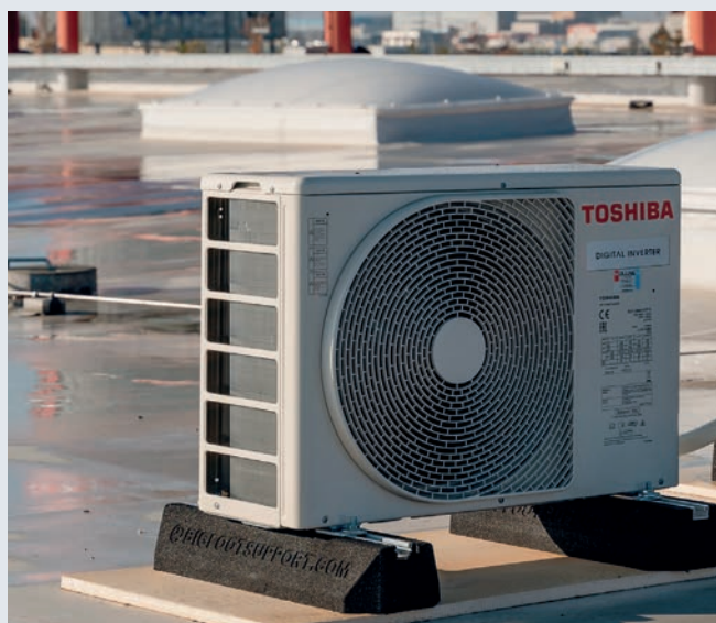
Nákupné galérie PADO v meste Parndorf, CAVERION Österreich GmbH – klimatizačné systémy a tepelné čerpadlá
